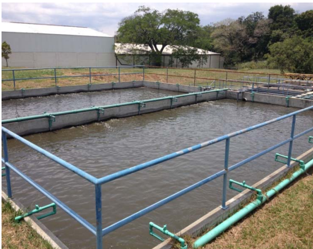
Figura 17: Planta de tratamiento de efluentes.
