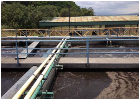
Figura 49: Planta de tratamiento de Efluentes. Fuente: Fotografía tomada durante la visita al Sitio, Abril 2012.
