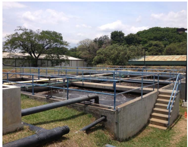
Figure 18: Planta de tratamiento de efluentes.
