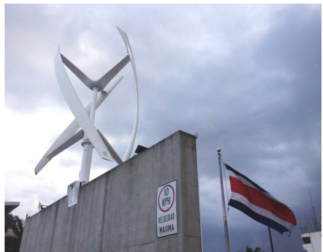
Figura 30: Aerogenerador en el estacionamiento.
