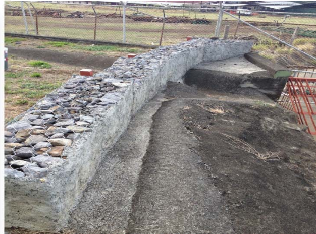
Figura 56: Medidas para prevenir inundaciones. Fuente: Fotografía tomada durante la visita al sitio, Abril 2013
