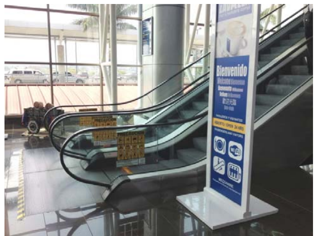
Figura 24: Escaleras con mecanismo de ahorro de energía.
